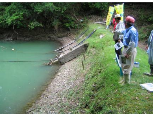
ため池の浸食状況調査 (古座川町:船原池)
