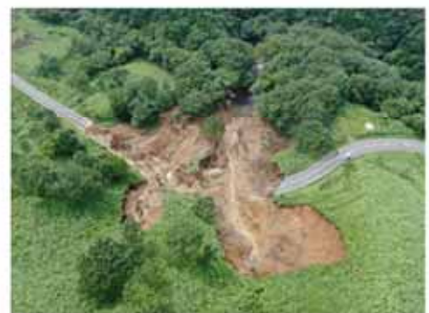
崩落した農道（南小国町）
