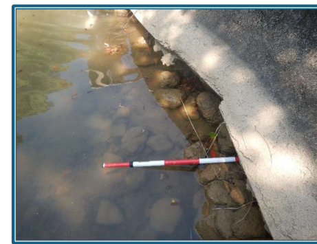
【法面がえぐられている】
