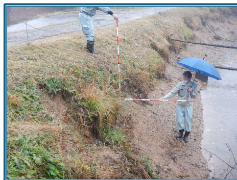
【堤体上流法面の浸食状況】
