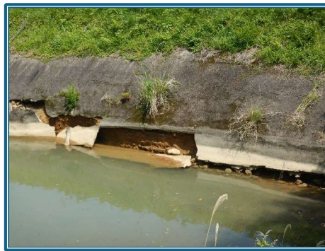
【法面コンクリート破損】
