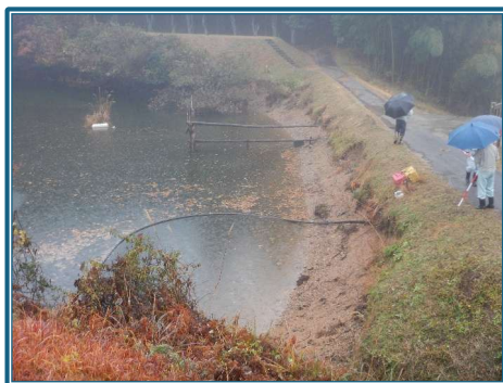
【堤体上流法面の浸食状況】
