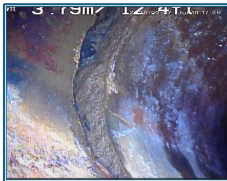
【底樋管の段差】
