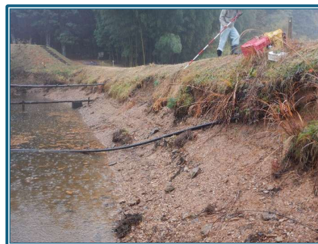
【堤体上流法面の浸食状況】
